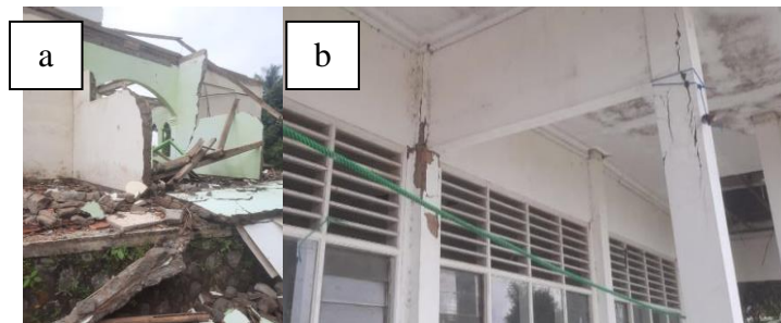
Gambar 2, (a) Keruntuhan dinding, (b) kerusakan kolom dan hubungan balok kolom, bangunan SDN Cijedil
