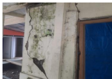
Gambar 4. Kerusakan pada kolom bangunan masjid
