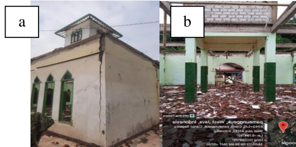
Gambar 3. Bangunan Masjid (a) retak pada dinding, (b) plafon dan lantai hancur
