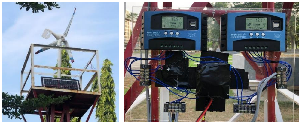
Gambar 2. Pengamatan Turbin Angin dan Photovoltaic
