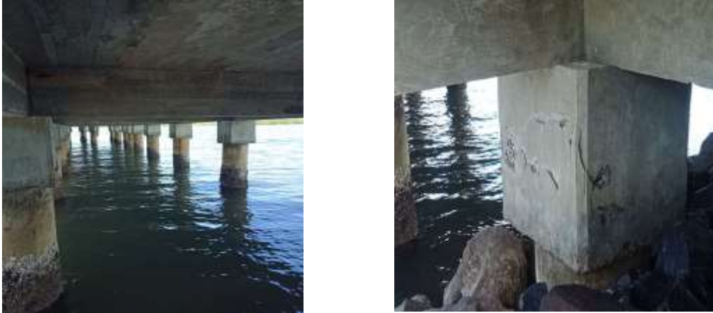
Gambar 4. Kondisi eksisting kerusakan pada pier jembatan
