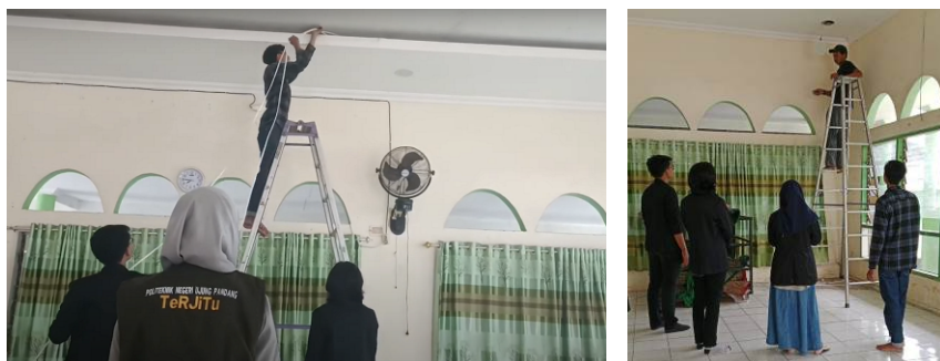
Gambar 4. Instalasi Kabel Indoor dan Outdoor UTP CCTV
