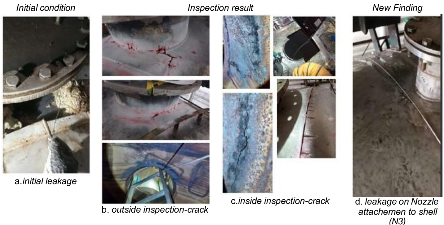
Gambar 1. Hasil inspeksi yang telah dilakukan terhadap Thermal deaerator Vessel capacity 150 m 3
