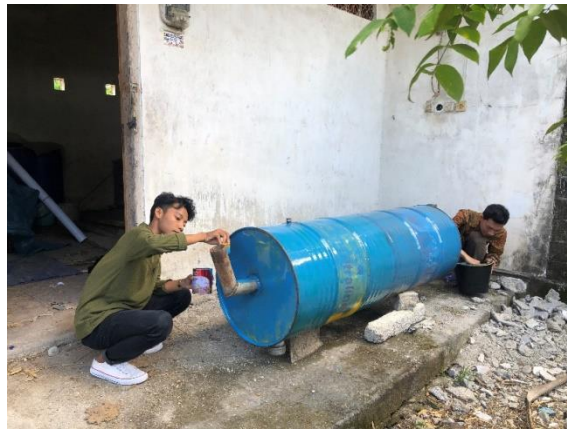
Gambar 2. Digester Biogas yang Telah dimodifikasi
